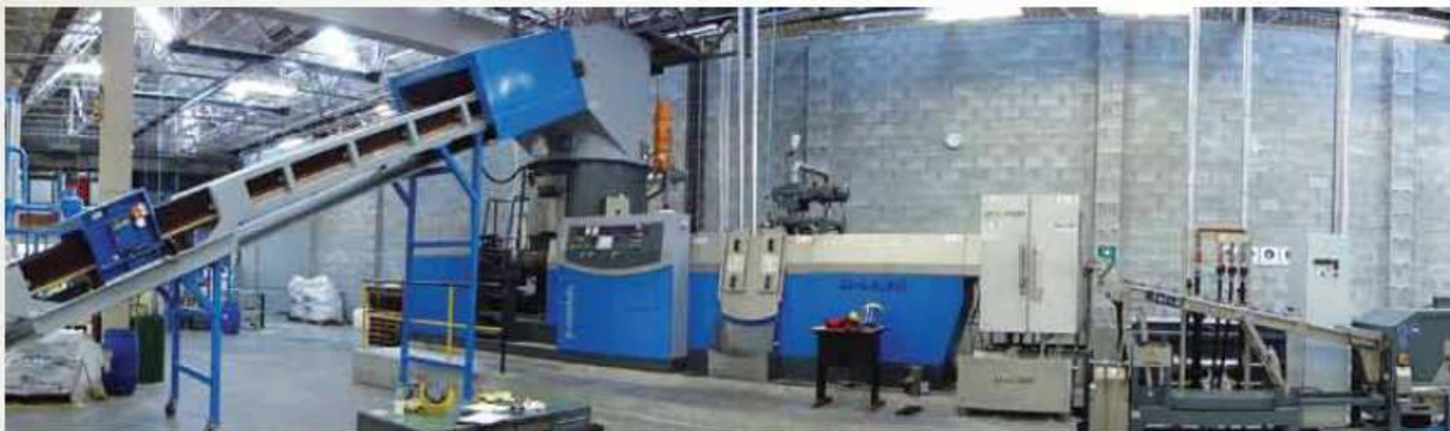
Planta de Reciclaje, ENKA
